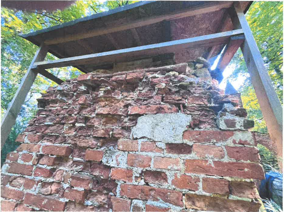
zdjęcie nr 9 degradacja górnej części muru widok południowy południowy
