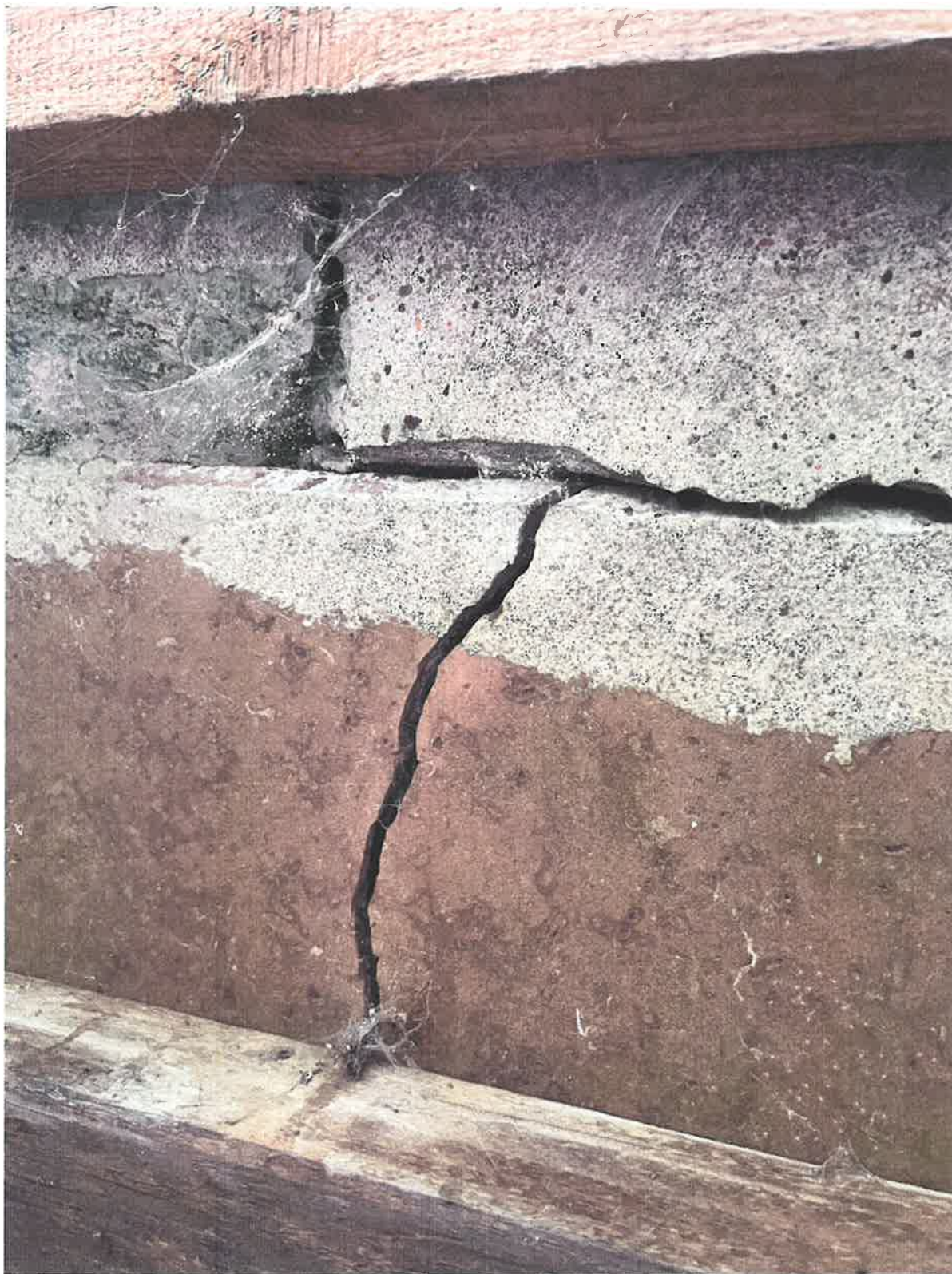
zdjęcie nr 8 Pęknięcie tramu i płyty stropowej
