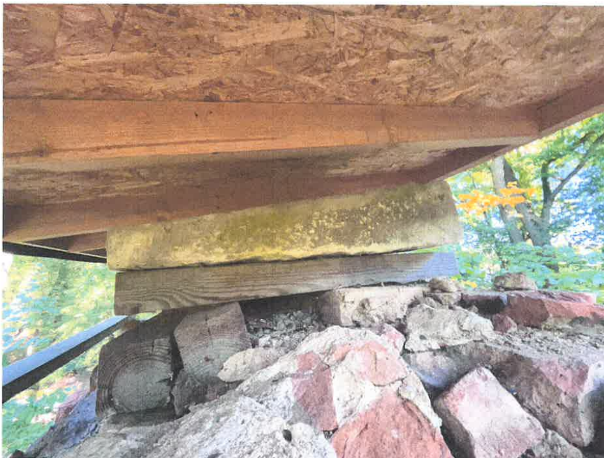
Zdjęcie nr 7 degradacja przekrycia widok południowy
